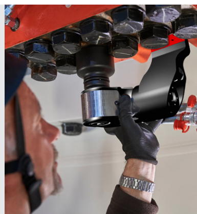
alkitronic® AT Einsatz in einer Windkraftanlage
