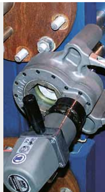
Bild oben: PWT von Alfa Laval Bilder rechts: alkitronic ® CLS-SG und RCL Drehmomentschrauber im Arbeitseinsatz an Plattenwärmetauschern.
