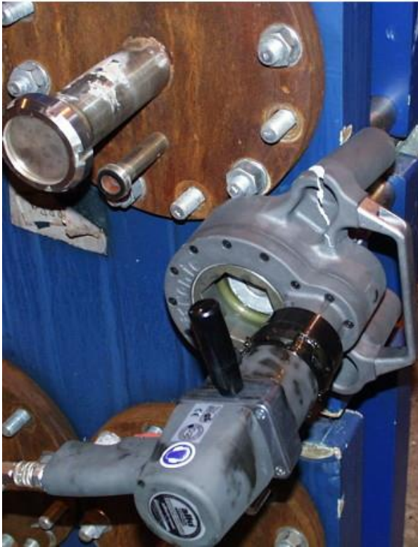
Abbildung 3: Verschraubung am Plattenwärmetauscher
